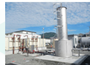
焼津市内 温泉からのメタンガス回収
