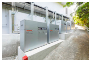
コージェネレーションシステム
