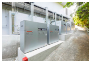
コージェネレーションシステム
